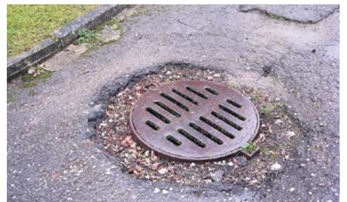
Rapla lasteaia Päkapiik maja ümbruses on lastel keelatud jalgrattaga sõita, sest asfalt on lagunenud ja kanalatsioonikaevude kaaned upituvad kõrgelt välja.
