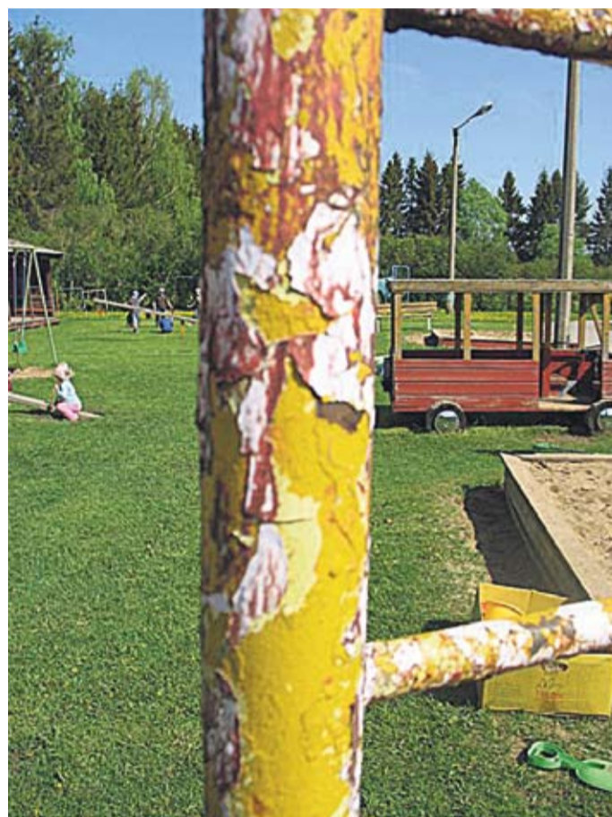
Tüüpiline, kuidas nõukogudeaegsed konstruktsioonid on hooldamata.
